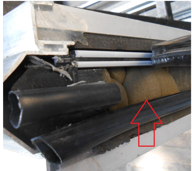
Figura 13 – Espumas que preenchem os montantes tubulares dos módulos.
